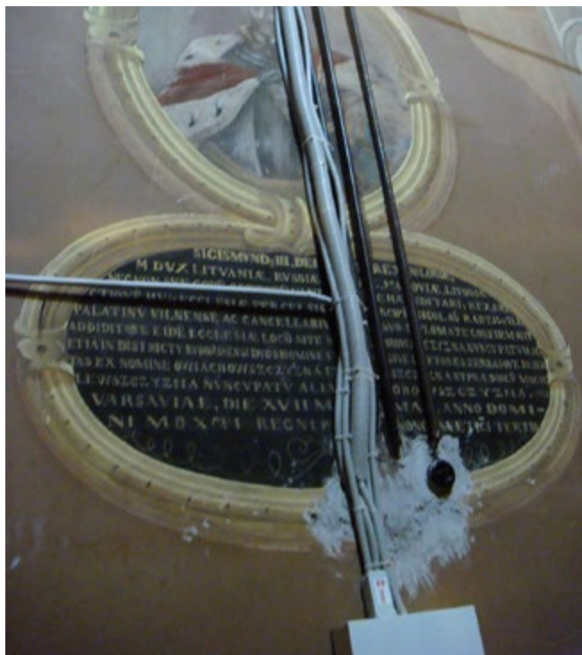
Netinkamai atlikti priešgaisrinės signalizacijos montavimo darbai Vilniaus Šv. Jurgio bažnyčioje
