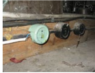
Techniškai netvarkinga elektros instaliacija objekte Senuosiuose Trakuose
